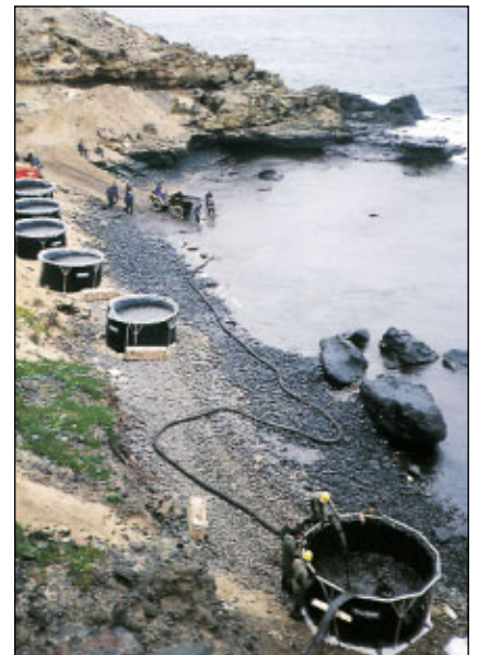
Residuos de hidrocarburos en almacenamiento temporal cerca de la línea costera
